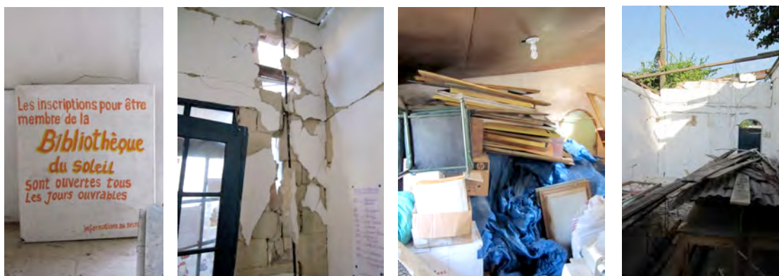
La Bibliothèque du Soleil, détruite lors du séisme. Les livres et le matériel sont rangés sous bâche dans un local adjacent. A droite, on peut voir ce qu'il reste de la salle informatique qui aurait du ouvrir le 12 janvier 2010.
