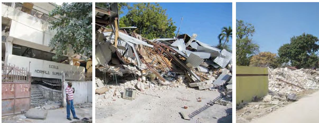
A gauche : le bâtiment de l'école normale supérieure, effondré sur lui-même. Au centre : Le bâtiment de la maîtrise Mémoire, Histoire et Patrimoine A droite : une autre faculté de l'UEH
